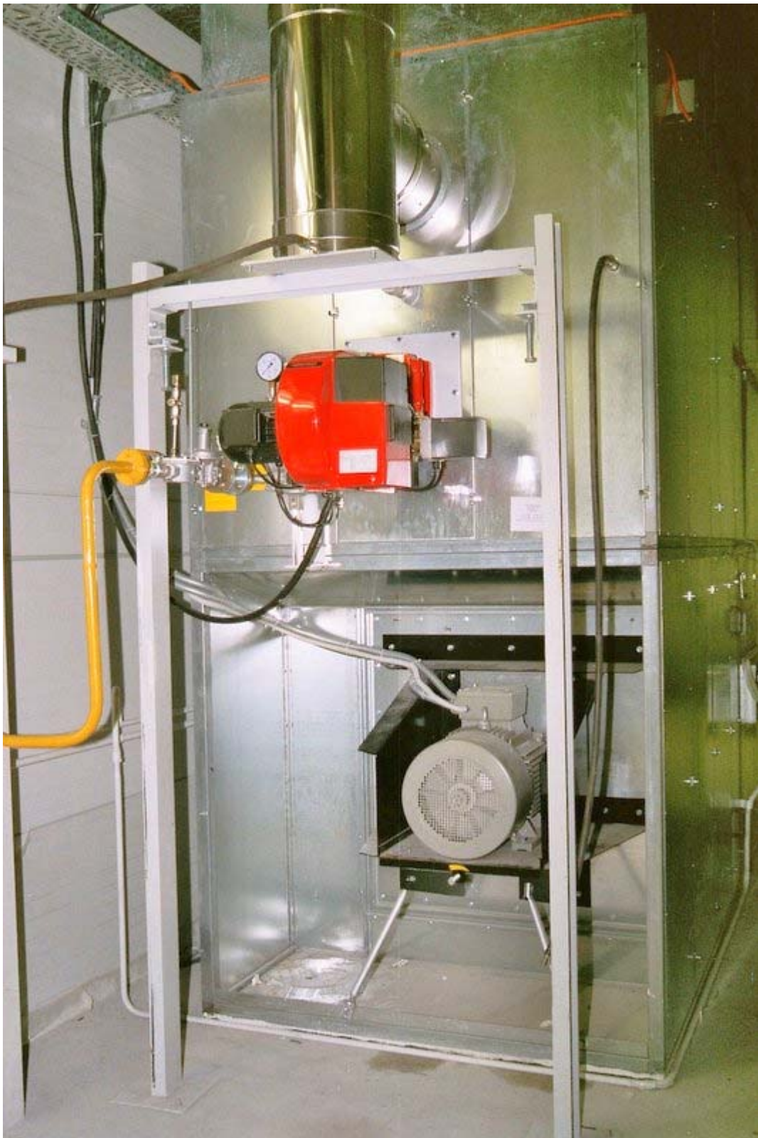
Brenner und Lüftung
